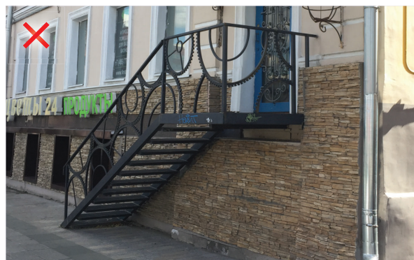
Входная группа не оборудована пандусом или подъемником для безбарьерного доступа.
